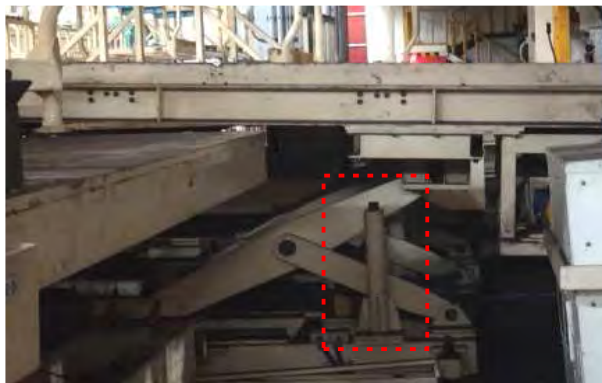
기복 컨베이어의 기계식 스토퍼
