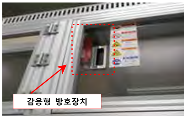
감응형 방호장치가 설치된 점검문
